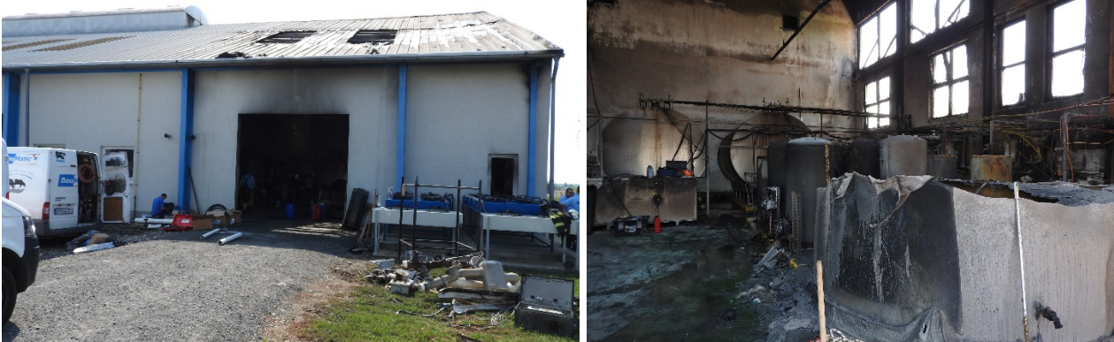
Obr. 9-10 – pohľad na požiarom poškodenú strojovňu
