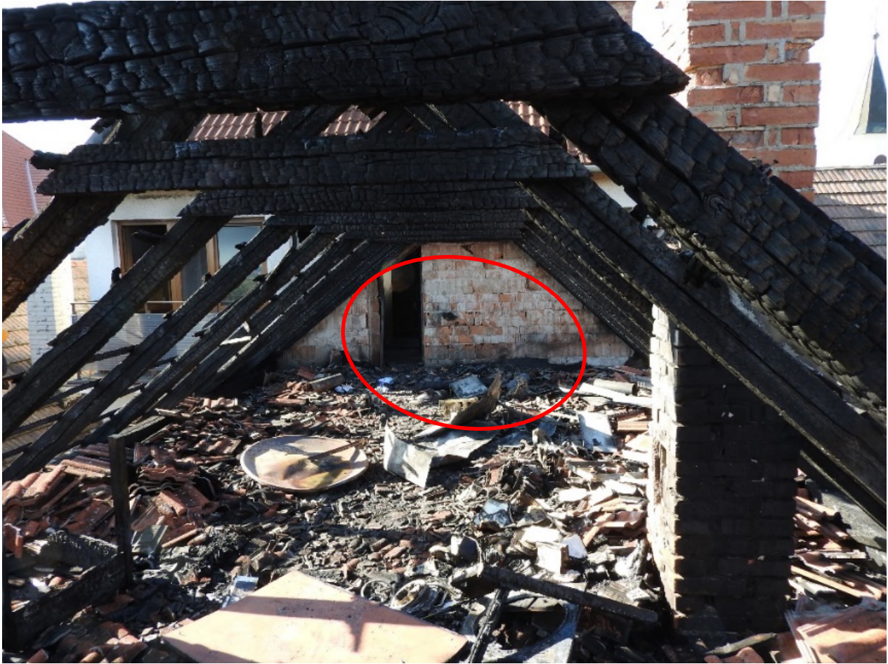
Obr. 2 – pohľad na kriminalistické ohnisko požiaru.
