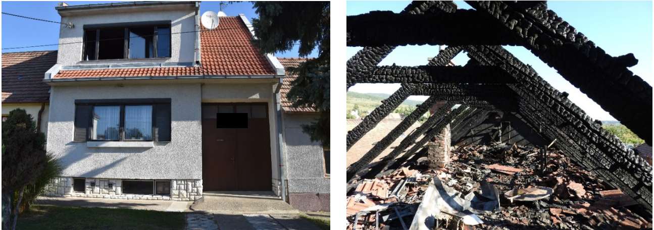
Obr. 1 – pohľad na požiarom poškodený rodinný dom.
